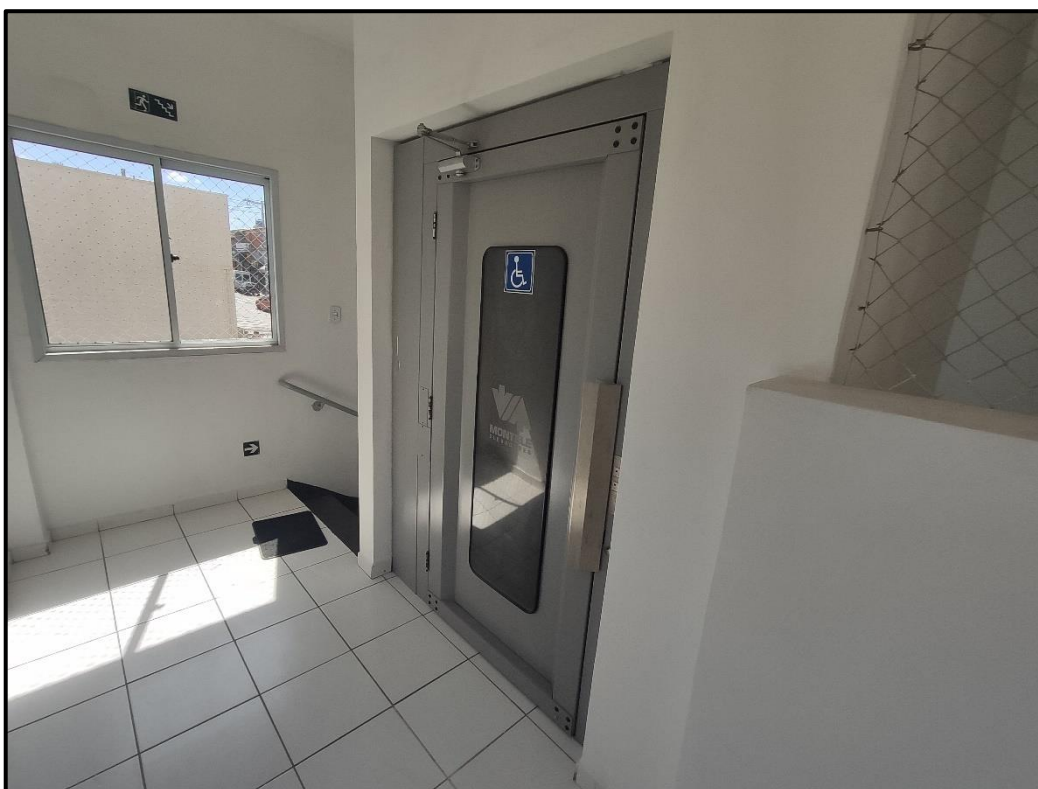
Ilustração 15: Área comum do condomínio – Plataforma elevatória
